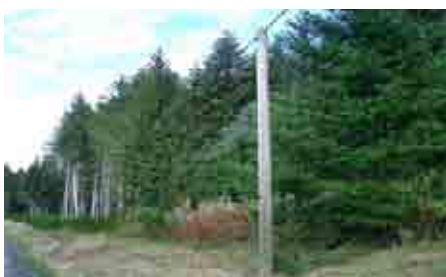
Poteaux telefoniques et electriques
